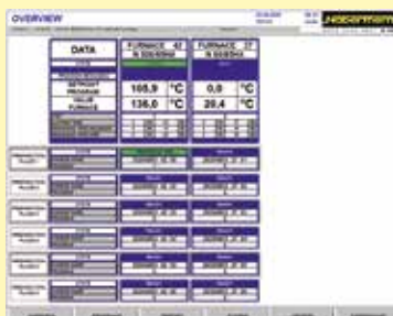
Vista general de la instalación
