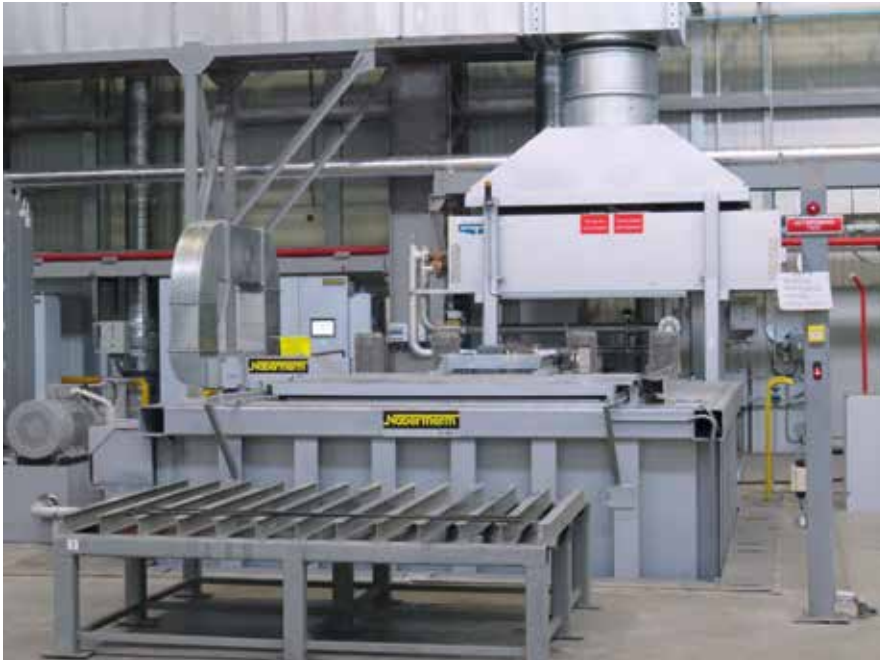
Bac de tremp à l'huile OAB 67000 avec échangeur de chaleur et contenant 67 000 litres d'huile
