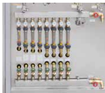
Circuit d'eau de refroidissement
