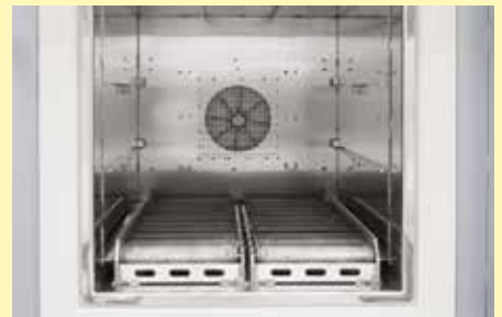
炉室内のローラーコンベヤ
